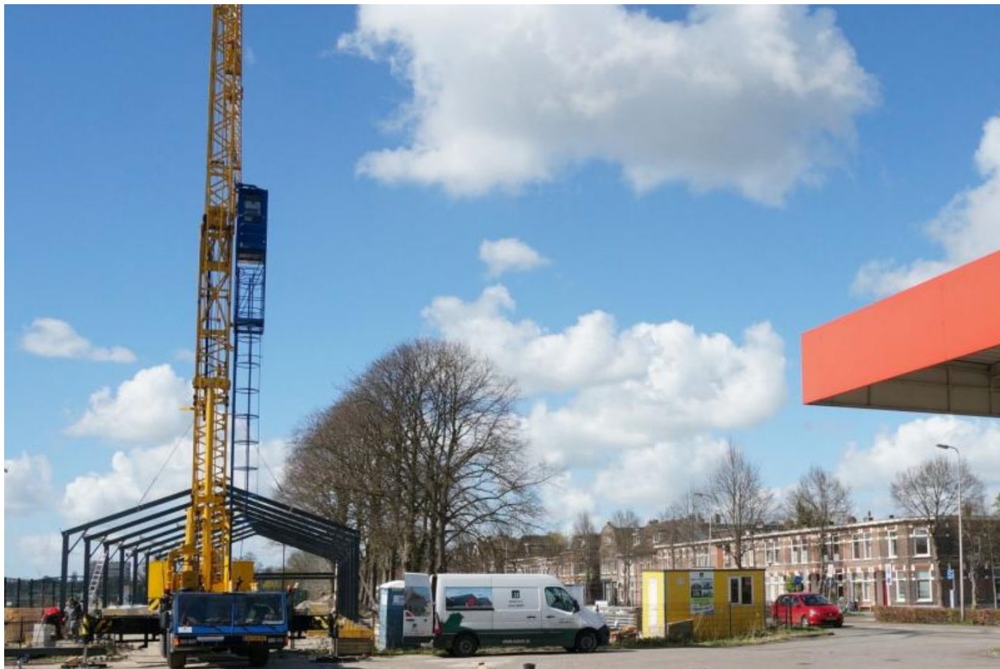
De nieuwbouw vanaf het benzinestation Firezone Met de kraan worden de dakplaten aangebracht
